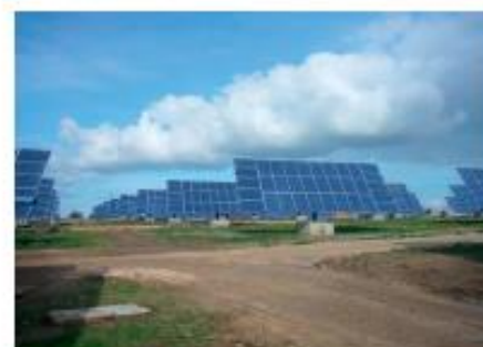
Multi Megawatt Solarpark mit DEGERtraker 7000NT, Italien.
