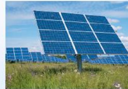
Firmeneigener Solarpark mit 107 DEGERtraker, Deutschland.
